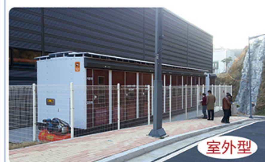
工矿企业室外型1250KVA*2
